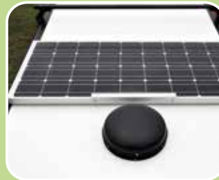
Solarmodul am Staudach
